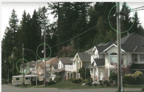
住宅地に設置されたスモールセル基地局
